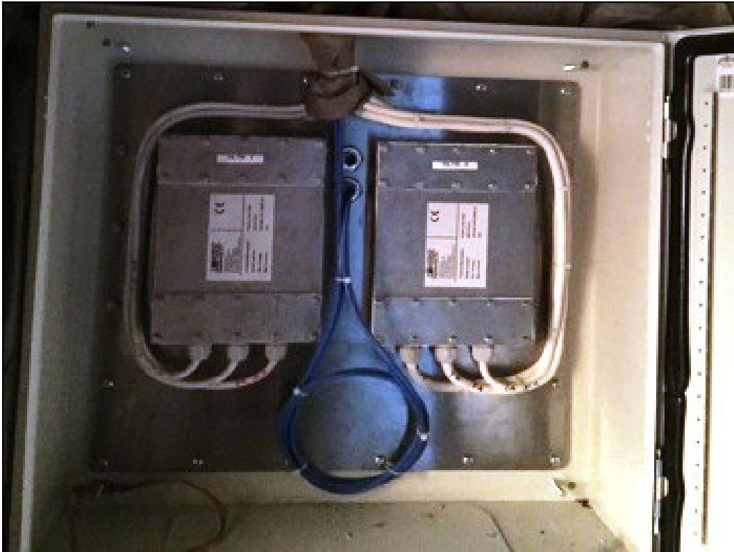
skrzynka z zainstalowanymi filtrami separacyjnymi
