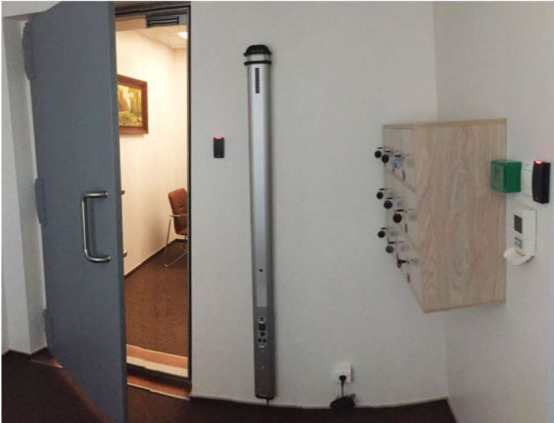
strefa specjalna - system wibroakustyczny, ekranowanie akustyczne, ekranowanie elektromagnetyczne, strefa kontroli z detektorem ferromagnetycznym, depozyt, system kontroli dostępu
